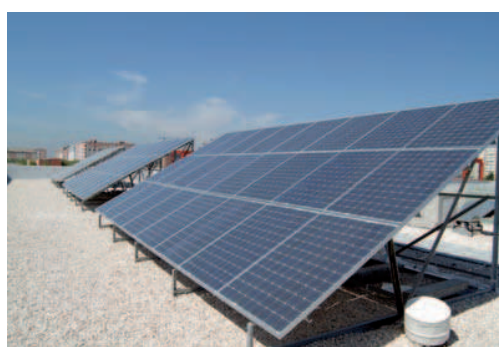
Paneles solares en uno de los centros de trabajo de Lipasam
